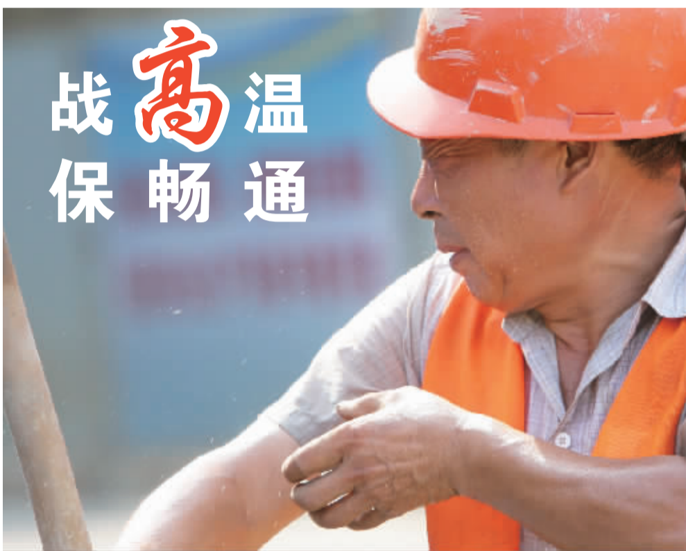
连续的高温给户外工作的人们带来考验，电力路改造施工的工人们汗如雨下奋战在工地上，以尽快完成改造，实现畅通。陶春 摄影报道
