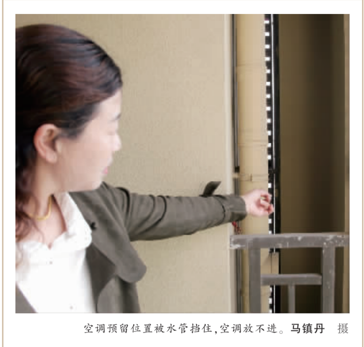
空调预留位置被水管挡住，空调放不进。马镇丹 摄
