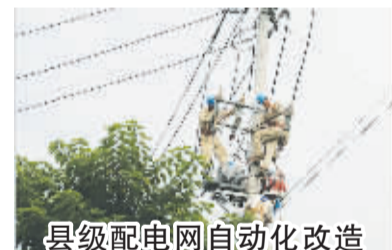
县级配电网自动化改造 经省电力公司统一部署，扬中成为全省首批开展县级配电网自动化全覆盖建设改造的试点城市之一。该工程总投资达7672万元，将完成全市122条配网线路的自动化改造，其中计划改造户内开关站6座、户外环网柜81台，柱上开关401台，于2016年7月底前完成。 耿阳 摄影报道
