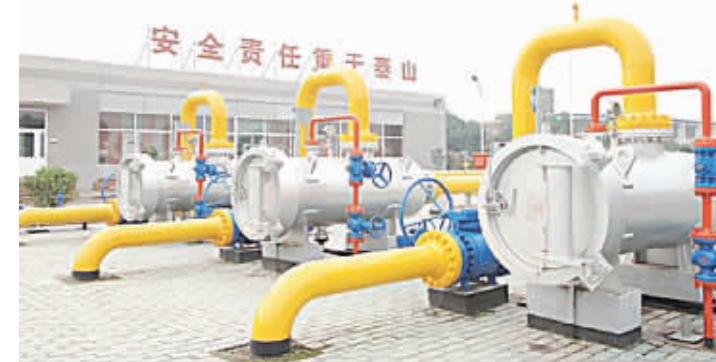
西气东输管道整治有序的站场
