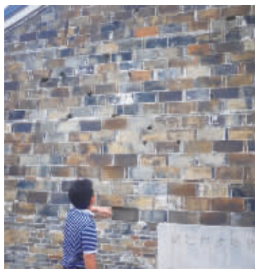
祠堂改建的纪念馆外墙上仍留有弹孔。
