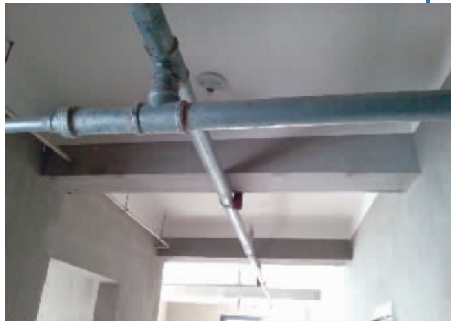
写字楼屋内喷淋管道
