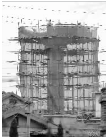
昨天,京口区第二批老旧小区水塔开始拆除。据了解,此次拆除的水塔共4座,由京口区建设局负责实施。由于拆除的水塔距离居民楼很近,只能采用人工搭架方式拆除。图为拆除现场。王呈 何利明摄影报道
